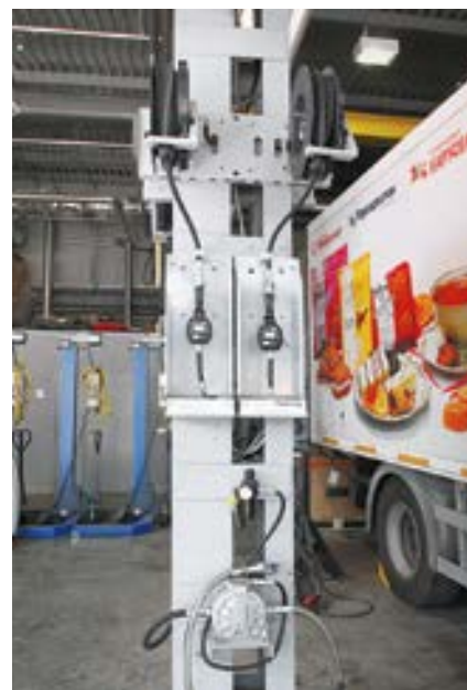
Автоматическая заправка технологических жидкостей — примета современной станции
