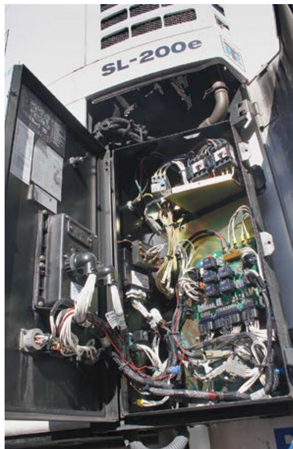
Начинка блока управления современной автомобильной холодильной установки напоминает внутренности компьютера. По сути это и есть компьютер
